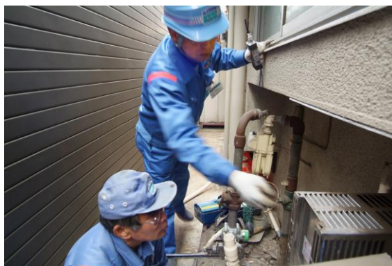
ガス機器の点検作業
