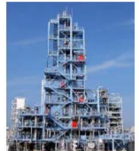
分離回収設備例
